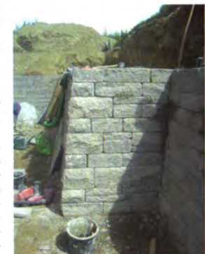
Die Landhaus-Mauer wird mit 12% Anlauf und Hinterbetonierung ausgeführt, um die Schubkräfte des anstehenden Hanges abzufangen.
