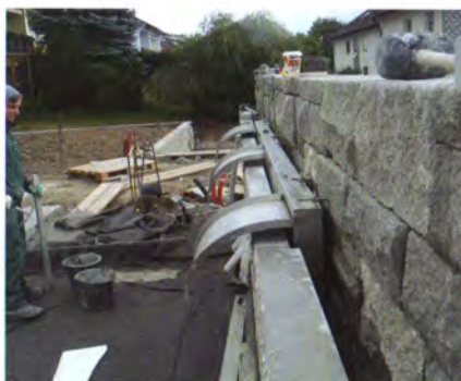
Dank der doppelschaligen Mauer konnte die komplette Technik für das Wasserspiel im Zwischenraum platzsparend integriert werden.
